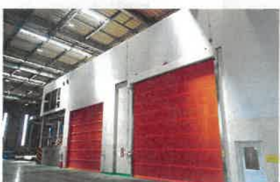
大型機器抜油・解体室
