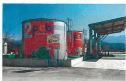
PCB廃油専用貯蔵タンク
